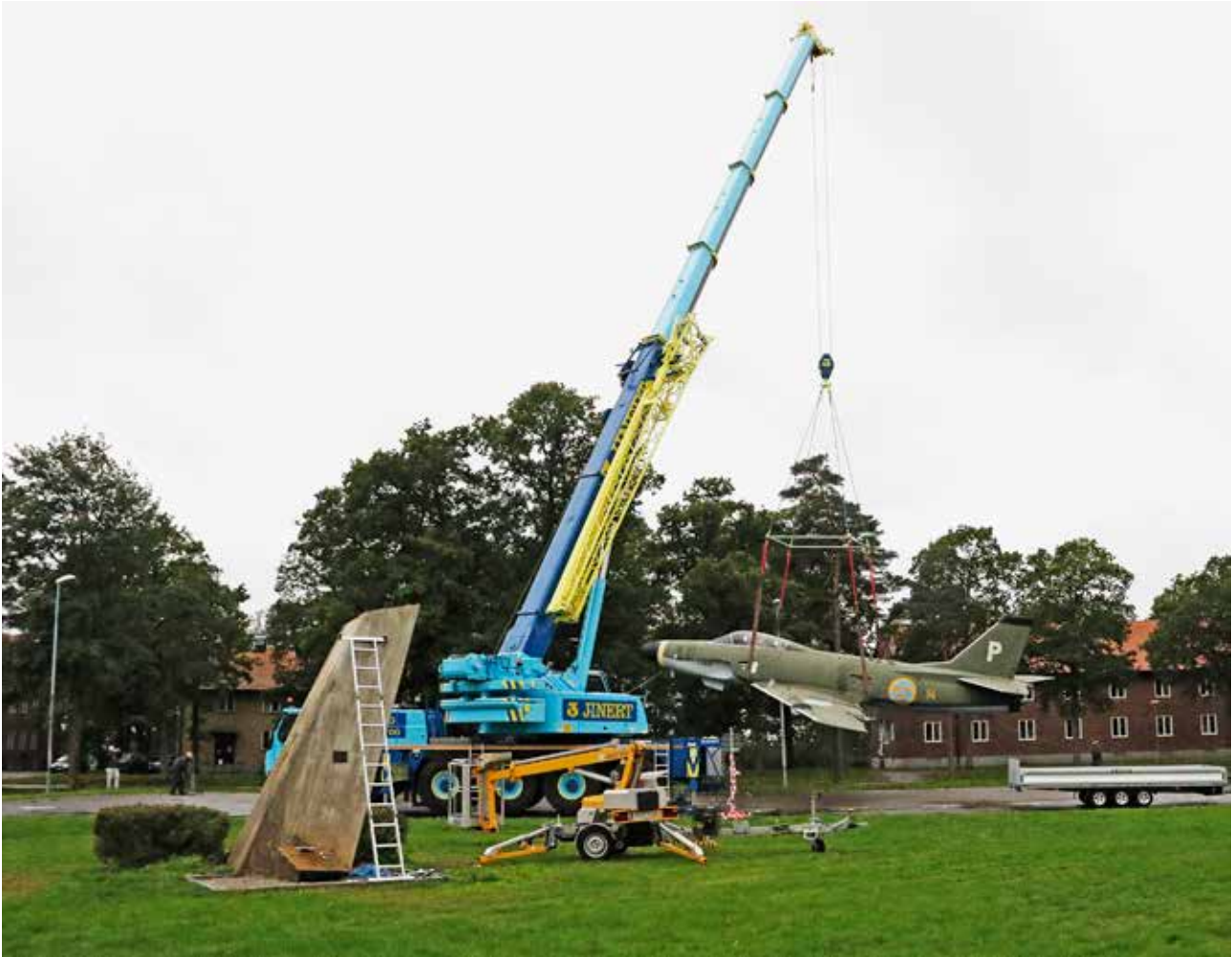
Lansen lyfts av pelaren. Nu väntar renovering av flygplanet. Foto: Christian Lövgren.
